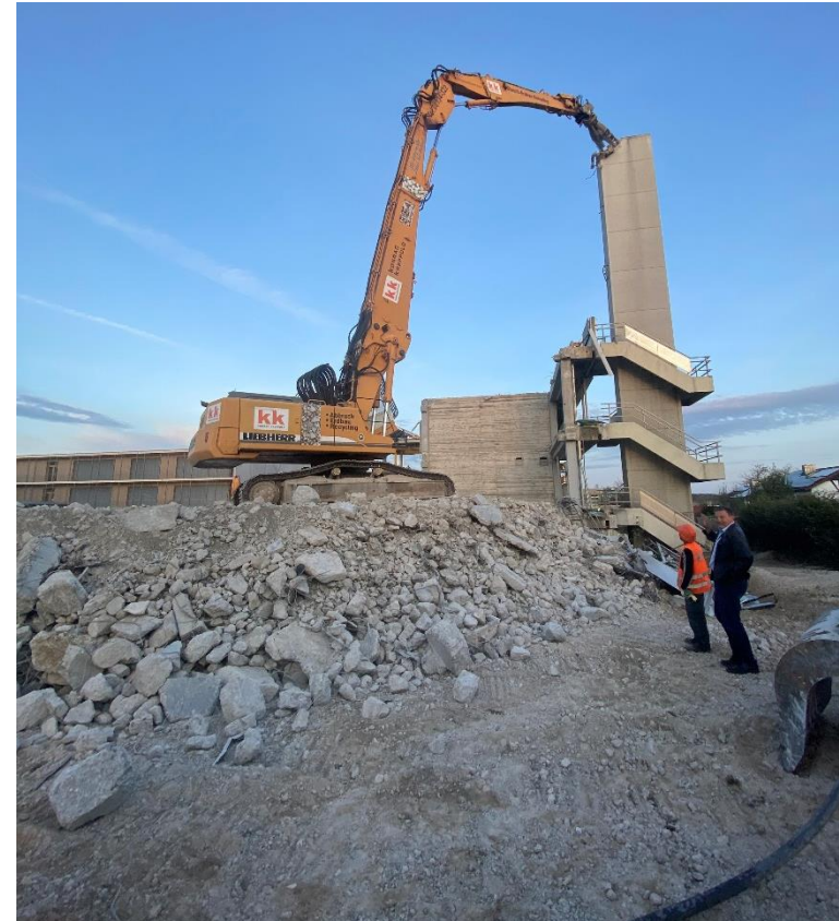
Foto: Zweckverbandsvorsitzender, Helmut Zech, mit einem Mitarbeiter der Firma Kreppold beim Abbruch der Kaminanlage der alten Grund- und Mittelschule.
